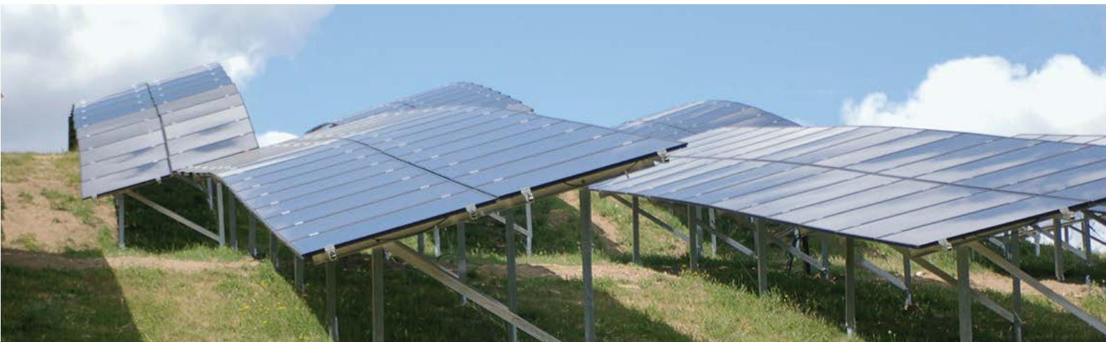
Solarpark Glasewitz – Anlageobjekt SOLARENERGIE NORD
