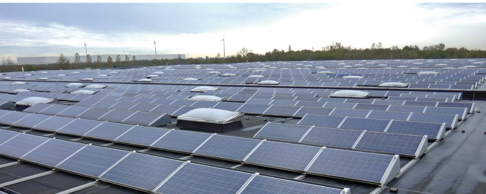
Beispiel einer Photovoltaik-Dachanlage
